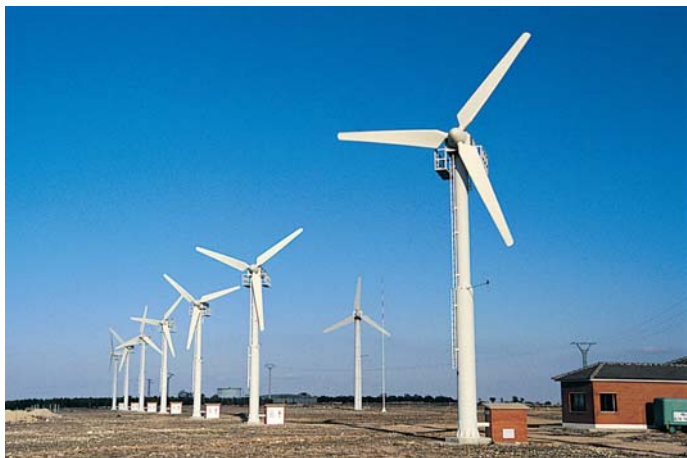
Parque eólico de La Muela (Foto: Luis Serrano)
