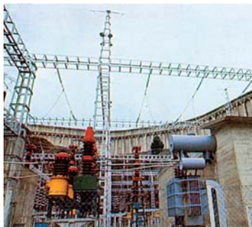
Instalaciones de la central hidroeléctrica de Mediano, Huesca (Foto: CHE)
