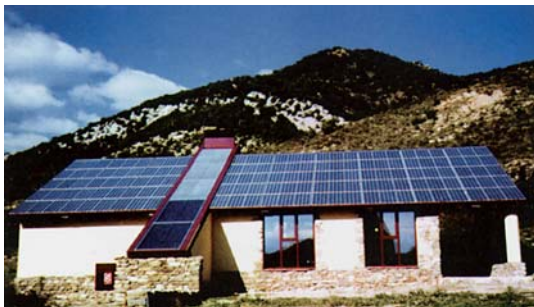
Instalación solar fotovoltaica en San Felices, Huesca (Foto: DGA)
