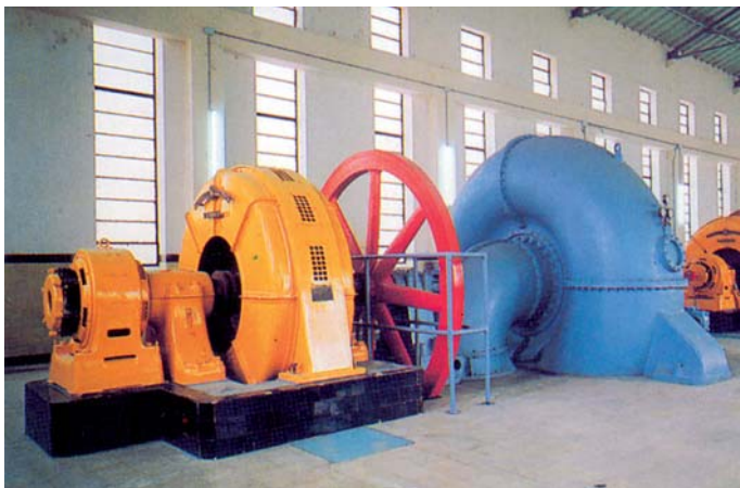
Generador de la central de Embid de la Ribera, Zaragoza (Foto: DGA)
