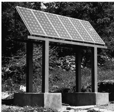
Sistema de electrificación rural en Castejón de Sos, Huesca (Foto: DGA)
