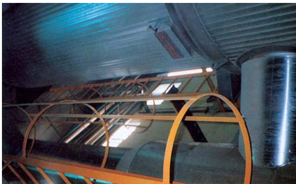
Caldera para calefacción en la carpintería Hermanos Pradas, de María de Huerva, que utiliza como combustible polvo de lijado de la madera (Foto: DGA)
