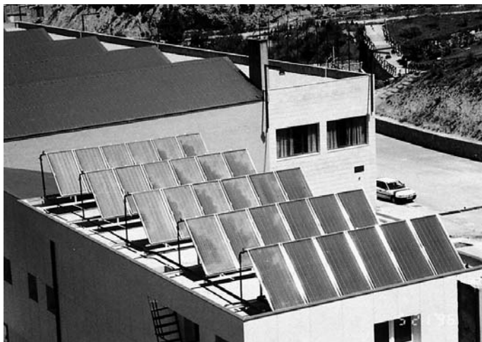
Polideportivo de Alcorisa con paneles de captación de energía solar (Foto: DGA)
