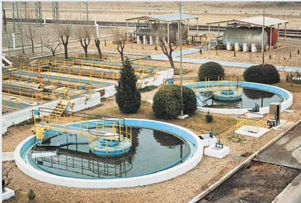
Planta de tratamiento de aguas, dotada de instalaciones de alta tecnología
