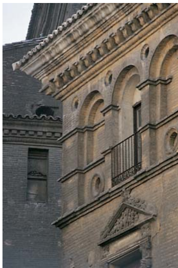
Cornisa de la casa llamada de los Mortanes, en la plaza de San Carlos de Zaragoza (Foto de la autora)
